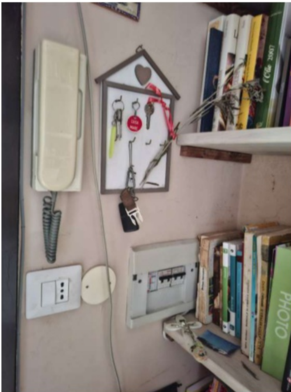
Disimpegno (quadro elettrico + citofono)
