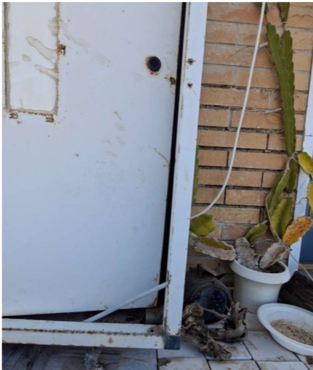
Particolare involucro caldaia
